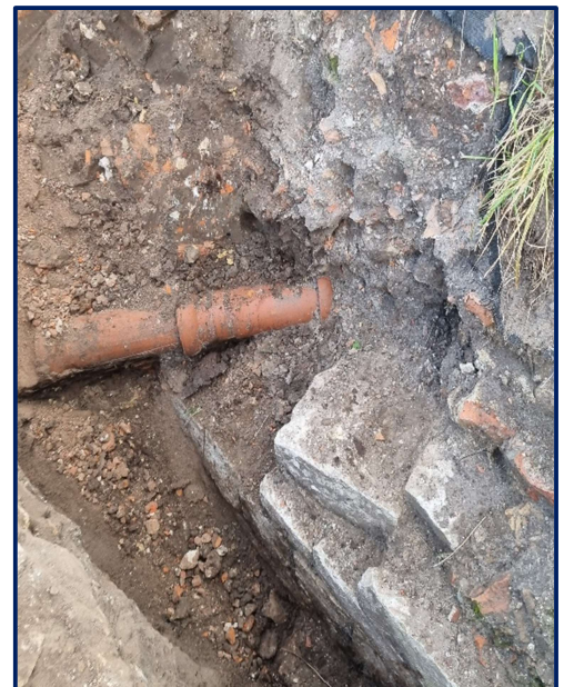
Foto 3: Schade uit het verleden aan de boogconstructie door het ingraven van drainage. De drainage bestond toen nog uit aaneengesloten aardewerk buizen.
